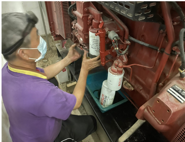
發電機引擎廢機油洩漏
