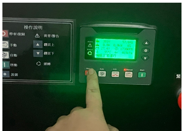
發電機組試運轉無異常
