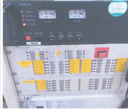
緊急廣播主機系統連結測試正常
