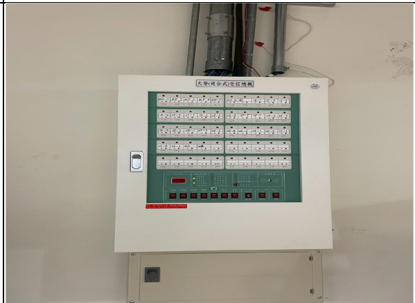
火警總機幹線配置完成系統正常定位
