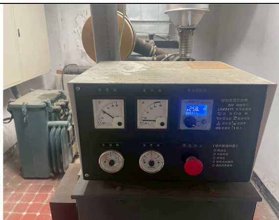
發電機大保養完成啟動測試正常
